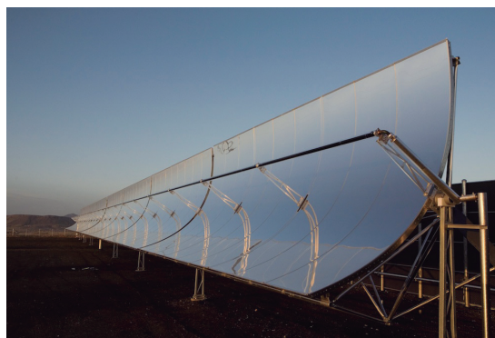
Figura 2.3 Instalaciones solares CPV
